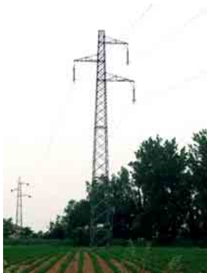
Alta tensione a singola terna
